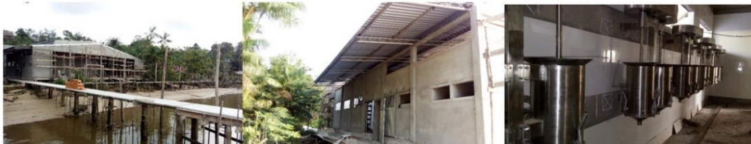
Figura 61 – A construção da fábrica. Evolução da obra da Fábrica Marajó Frut Fonte: a autora
