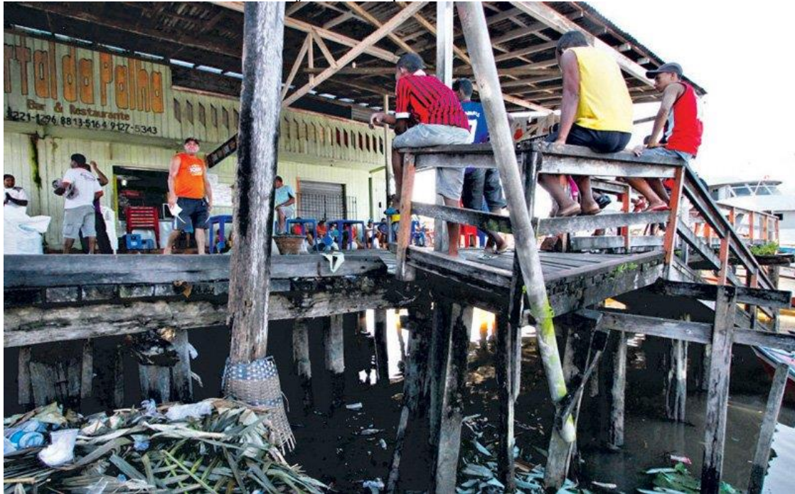
Figura 16 – Trapiche quebrado 1. Comerciantes se expondo ao risco de desabamento. Foto: Fernando Araújo. Fonte: https://www.diarioonline.com.br/
